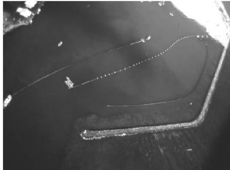
شکل ۱۲-۲۲ تصویر هوایی از سه بخش لوله‌ی آب سرد به قطر ۱ m و طول کلی ۱۹۱۶ m در بندر Kawaihae هاوایی قبل از اینکه به سایت NELHA کشیده شده و نصب گردند (منبع: Luis Vega )
